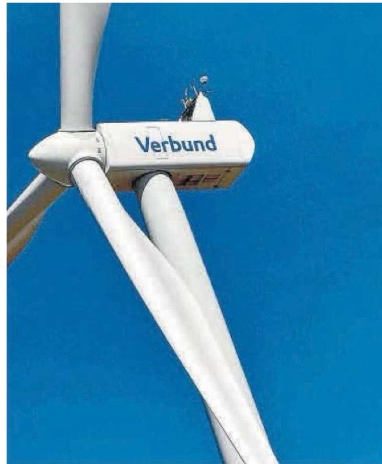
Aerogenerador del parque eólico de Santos de la Piedra. HERALDO
